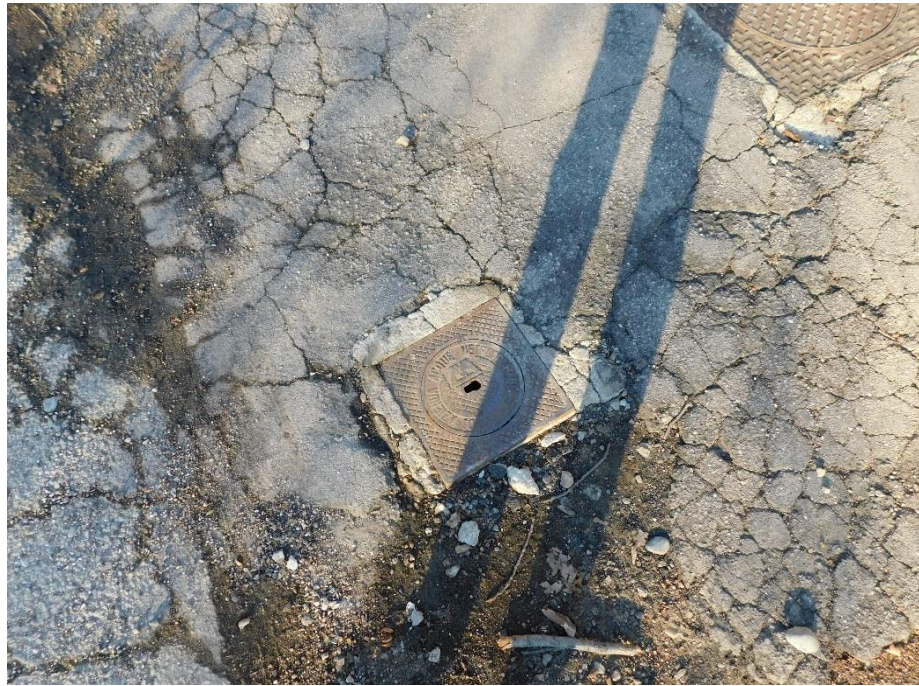
Foto 4. Particolare ammaloramenti su asfalto
