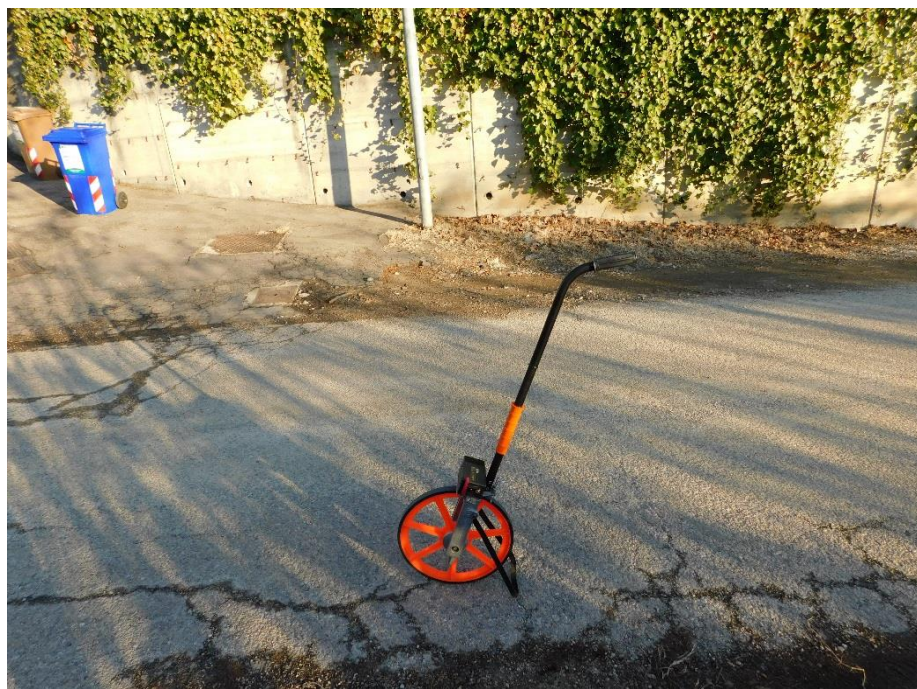
Foto 3. Particolare ammaloramenti su asfalto
